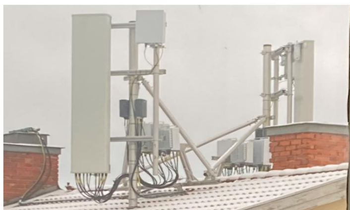
Figure 2 : Photo de la station de base 5G avec antennes dirigées vers l'appartement étudié.
